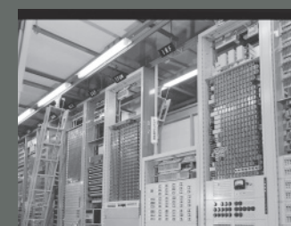
1号Aトラヒック監視装置 (1962) クロスバ交換機用トラヒック測定装置
