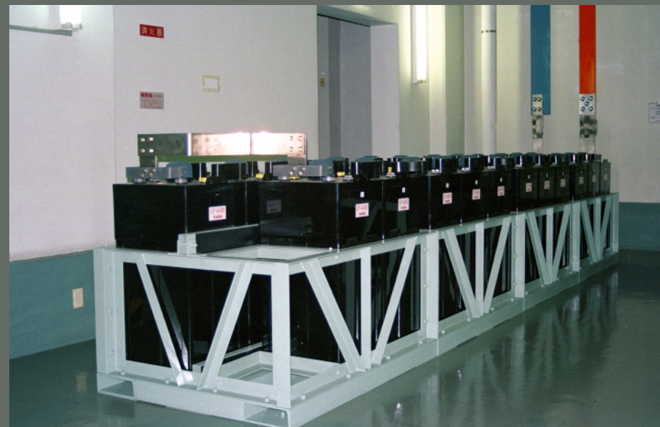
液式鉛蓄電池
