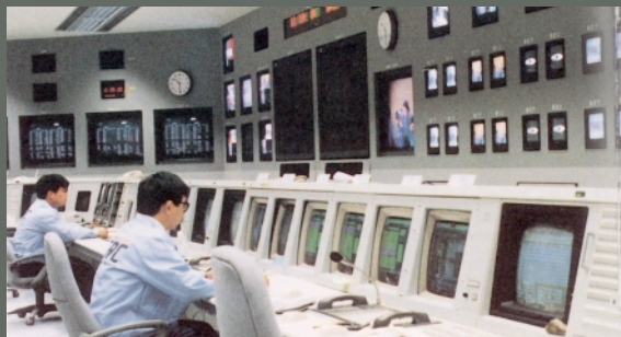
オペレーションルーム
