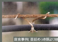
腐食事例(亜鉛めっき鋼より線)
