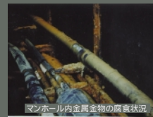
マンホール内金属金物の腐食状況
